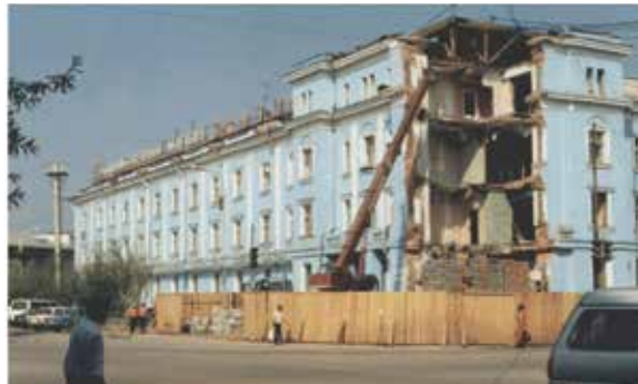
Fig. 2.8.11. Prăbușirea colțului clădirii, centrul orașului Yakutsk (Rusia).
